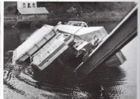
Phase de remontée d'un module. Module raising stage Fase de subida de un módulo
