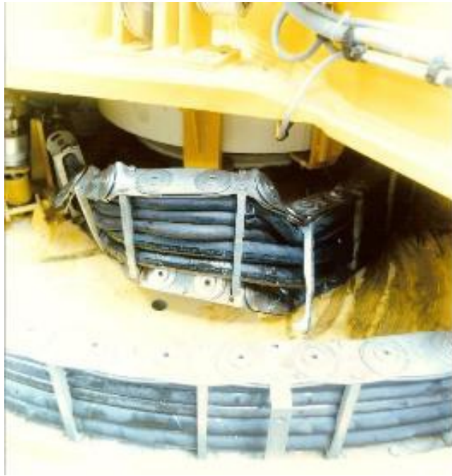
23 - Incident sur chaîne porte-câbles-1989 - Incident on cable support chain
